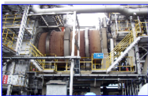
潮見工場の焼却施設
