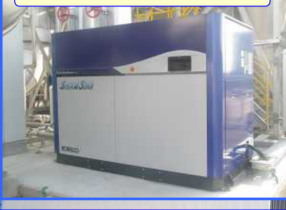
KOBELCO製132kw発電機
